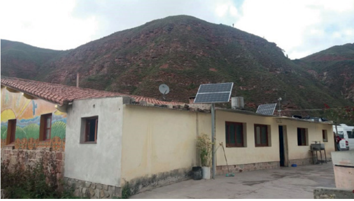
Imagen 2 – Paneles solares para población rural alejada de las redes eléctricas, localizada sobre la ruta 33 a 80 km de la localidad de Cachi (Provincia de Salta, 2016)
