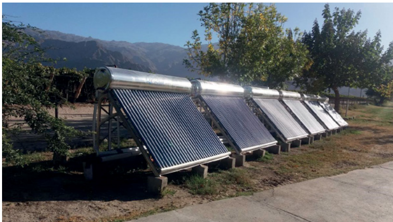
Imagen 5 – Colectores solares en unidad de producción de quesos de leche de cabra (Provincia de Salta, 2016).
