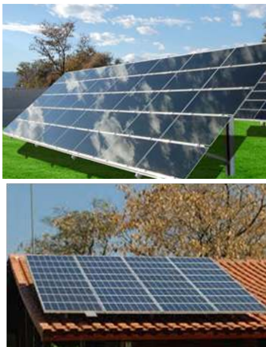
Figura 6 Instalação dos painéis fotovoltaicos no solo, em telhados e fachadas de prédios
